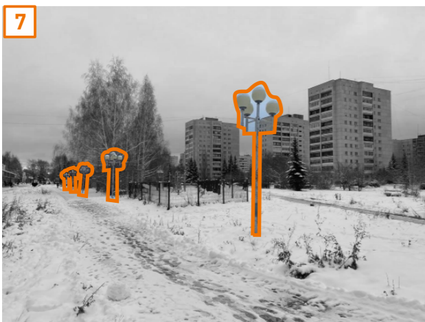
7 Не работающие и требующие ремонта фонари.
